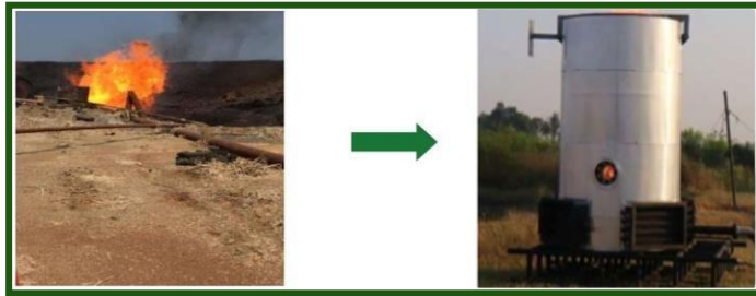
Gambar 4. Perubahan Sistem Pembakaran Gas Flare Test Unit dari Sistem Terbuka menjadi Enclosed System
