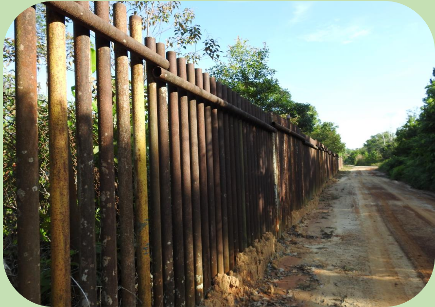
Pagar untuk Pembatasan Area Konservasi
