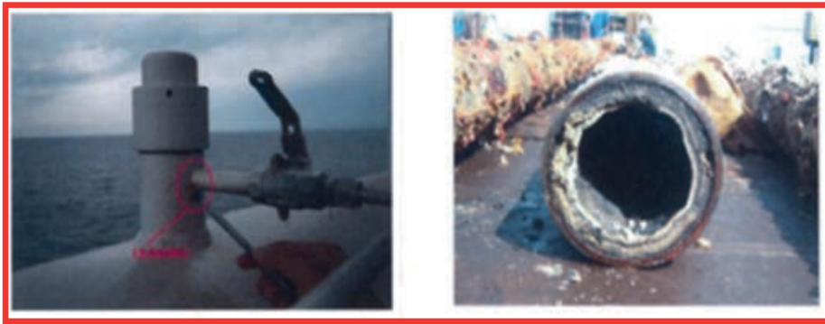
Gambar 84. Titik Injeksi dan Contoh Kebocoran pada Pipa serta Keadaan Pipa Sebelum Progres TEE LESS
