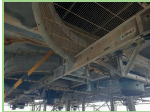
Gambar 12. Inovasi ABANG pada Fin Fan Cooler
